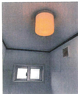
照明・換気扇
